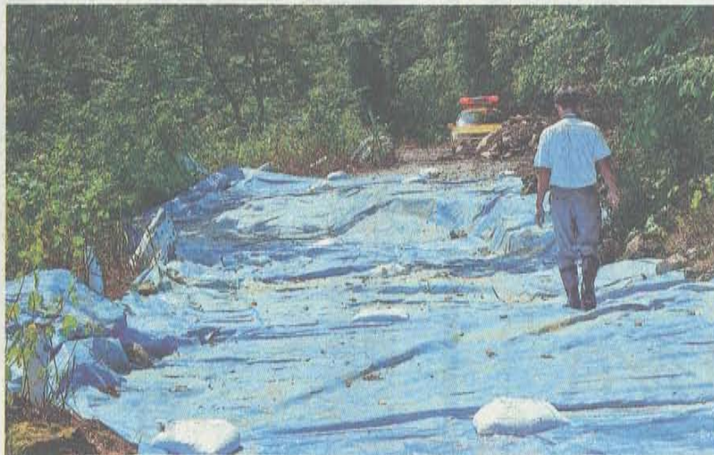
昨年9月の台風12号の影響で陥没した新温泉町の町道畑ヶ平線。災害に強いインフラ整備が求められている
